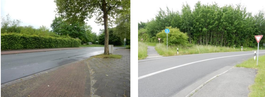
Abb. 36 Ungesichertes Ende eines Radweges (links) und ungesicherte Überquerung hochbelasteter Straße (rechts)
